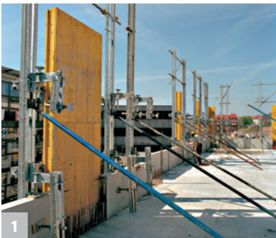
1 Das aufwendige Schalen mit Hilfe von Randtischen in Verbindung mit den Decken entfällt.
