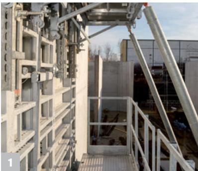
1 Arbeiten immer aus einem sicheren Bereich heraus.
